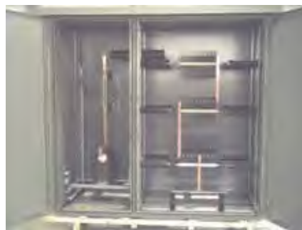
Erdungswiderstand mit Trennschalter und Stromwandler, Schutzart IP33 Earthing resistor with disconnector and current transformer, protection degree IP33
