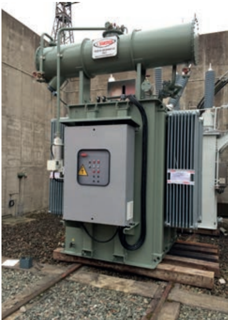
Tauchkernspule im Hochspannungsnetz mit Ausdehngefäß und beheiztem Luftentfeuchter
