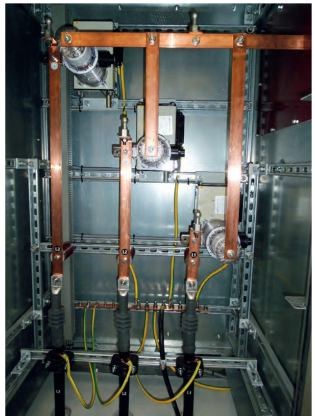
Bild 4. Leistungsschalterfeld der Phasenerdungsanlage im Umspannwerk Siemensplatz ▶
