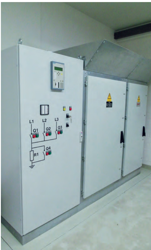
◀ Bild 3. 10-kV-Innenraum-anlage für die Phasenerdung: Steuerschrank mit Schutzrelais 7SJ62, Leistungsschalterteil und Widerstandsteil
