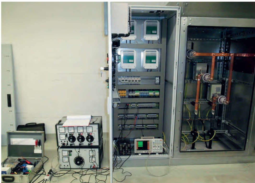
Bild 6. Inbetriebsetzung der Phasenerdungsanlage im Umspannwerk Siemersplatz durch mat
